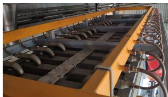
Рисунок 6. Общий вид системы газового инфракрасного нагрева
