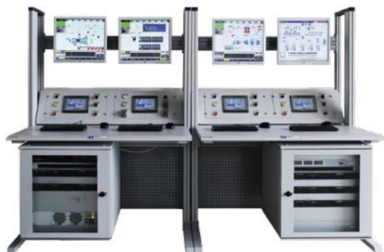
Рисунок 2. Автоматизированное рабочее место инженера в помещении цеха
